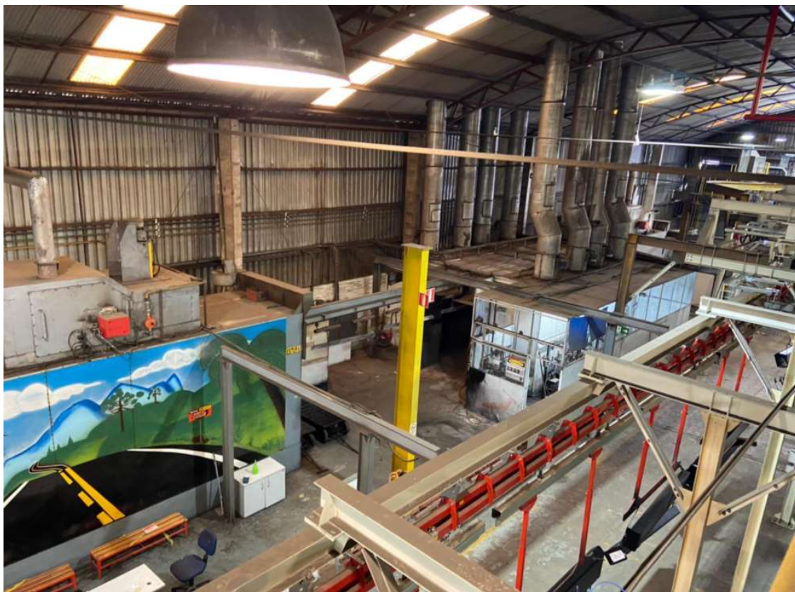
Figura 1 -Linha de Pintura completa, visão panorâmica.
